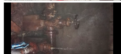
Perdita (in pozzetto) in Via Gregorio XI
