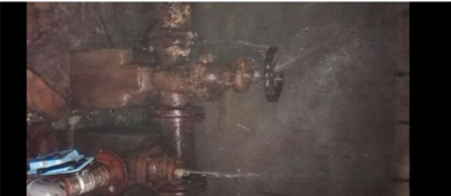
Leck (im Schacht) in Via Gregorio XI
